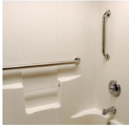
图6 浴缸旁加装扶手
